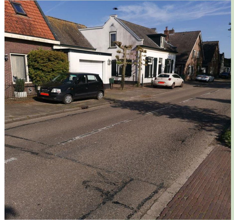
Schade aan asfalt
